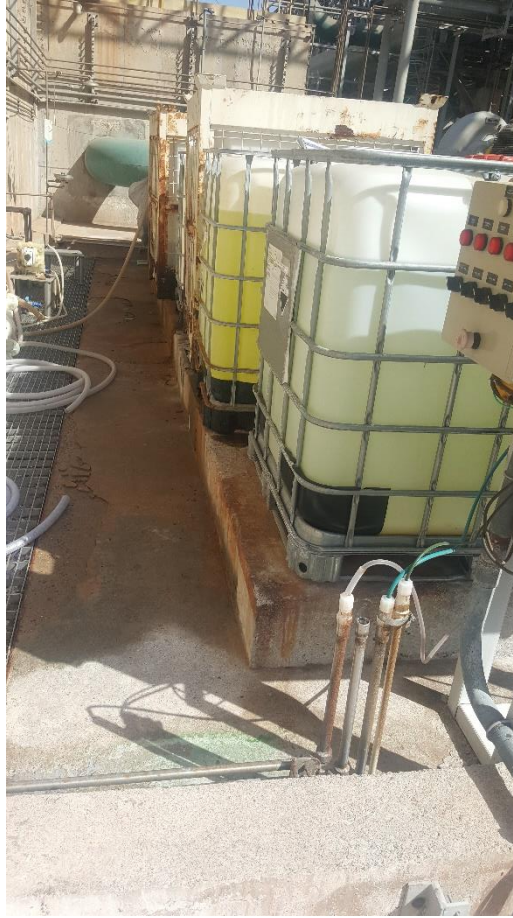
Figura 4.3 - Tubulação e válvulas corroídas (O autor, 2019)
