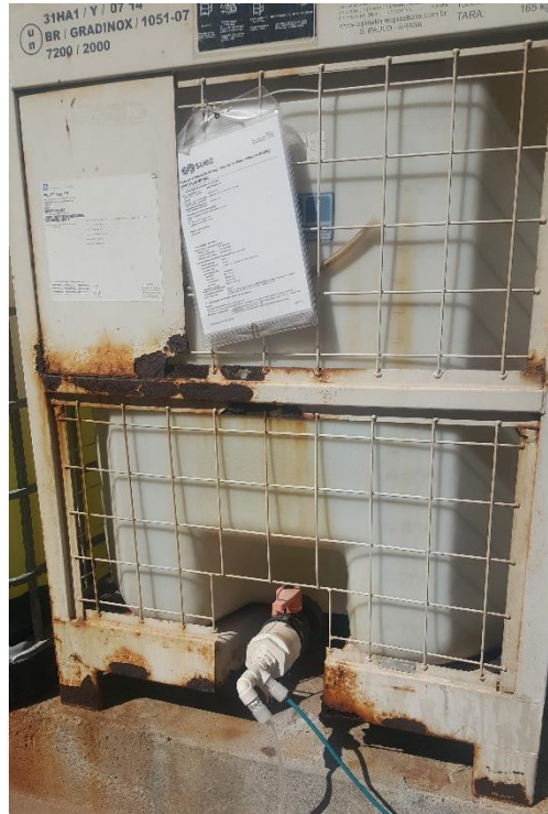
Figura 4.2 - Container de químico com focos de corrosão (O autor, 2019)
