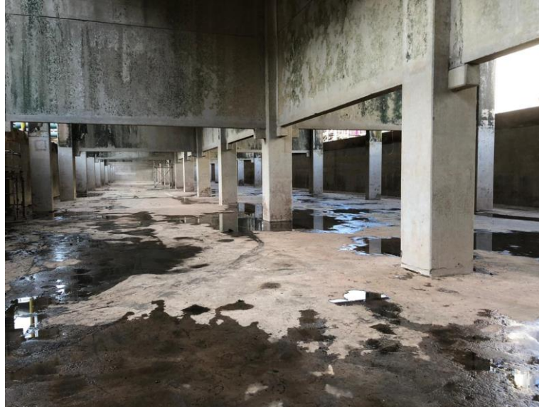
Figura 1.2 - Foto da Torre de Resfriamento da Suzano SA Unidade Imperatriz por dentro durante parada geral (O autor, 2019)
