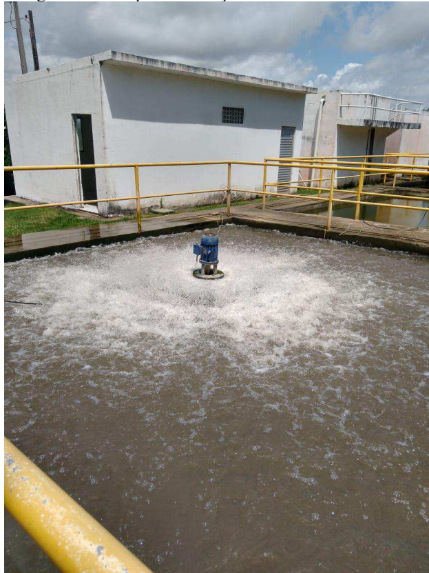
Figura 15: Tanque de Aeração com aerador flutuante
