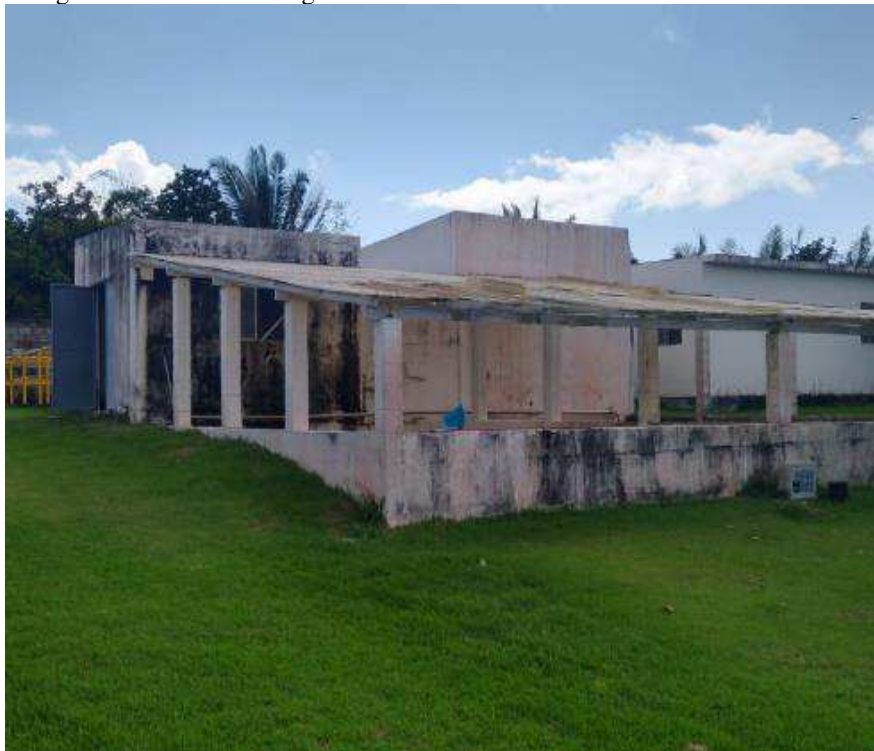
Figura 17: Leitos de secagem
