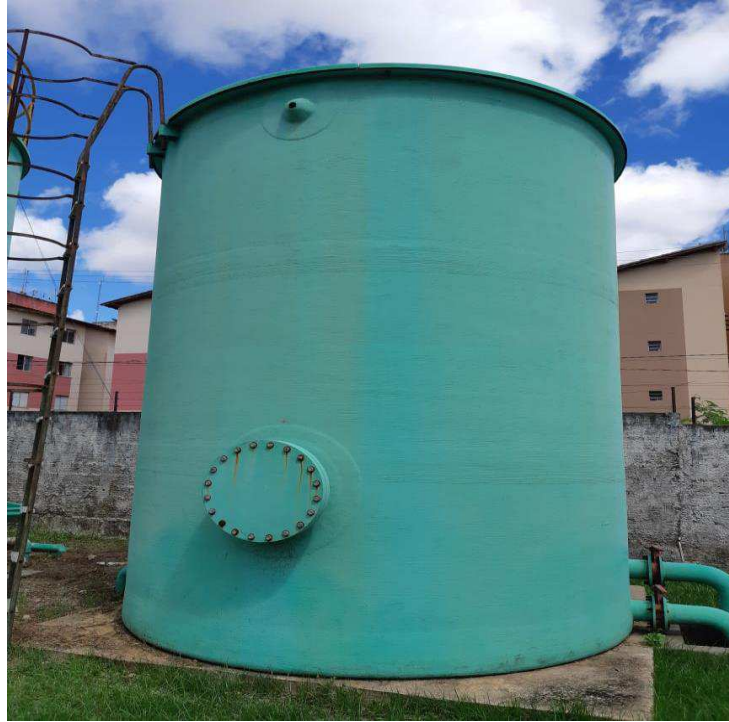
Figura 22: Filtro Submerso aerado com decantador secundário interno
