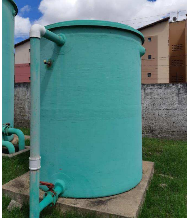
Figura 24: Tanque de contato
