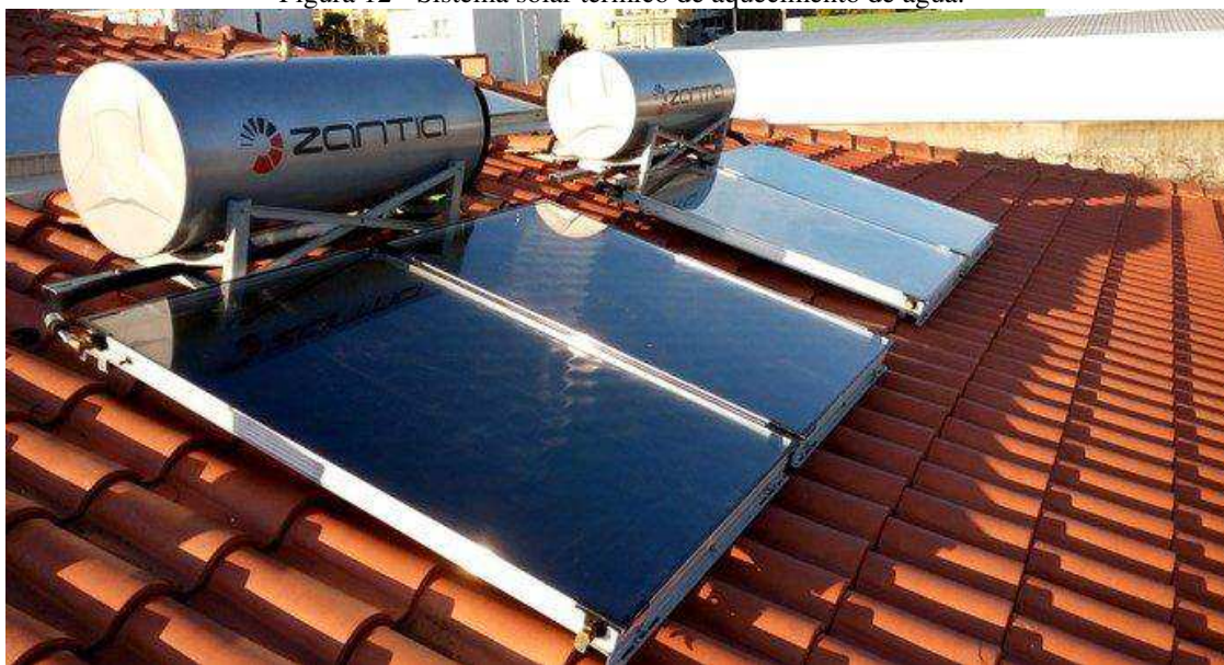
Figura 12 - Sistema solar térmico de aquecimento de água.
