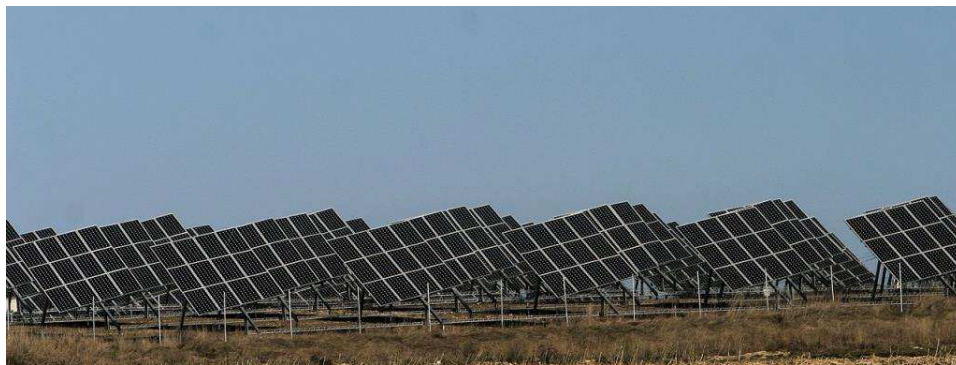
Figura 24 - Painéis de telureto de cádmio em uma usina solar.
