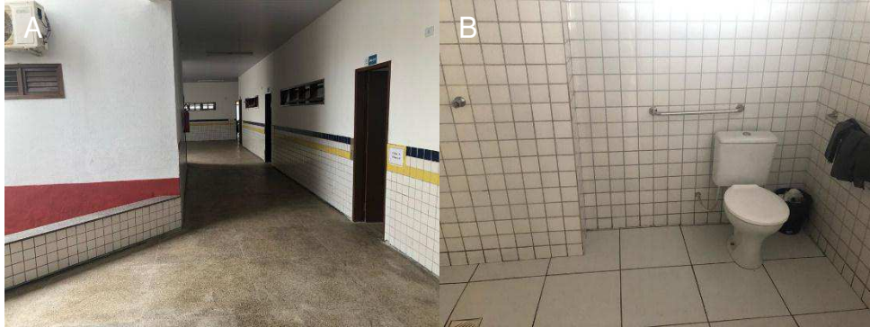
Figura 4 - Situações encontradas nas UBE's.
