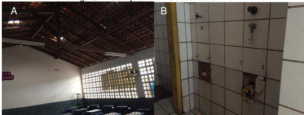
Figura 2 - Situações encontradas nas UBE's.
