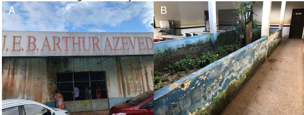
Figura 1 - Situações encontradas nas UBE's.
