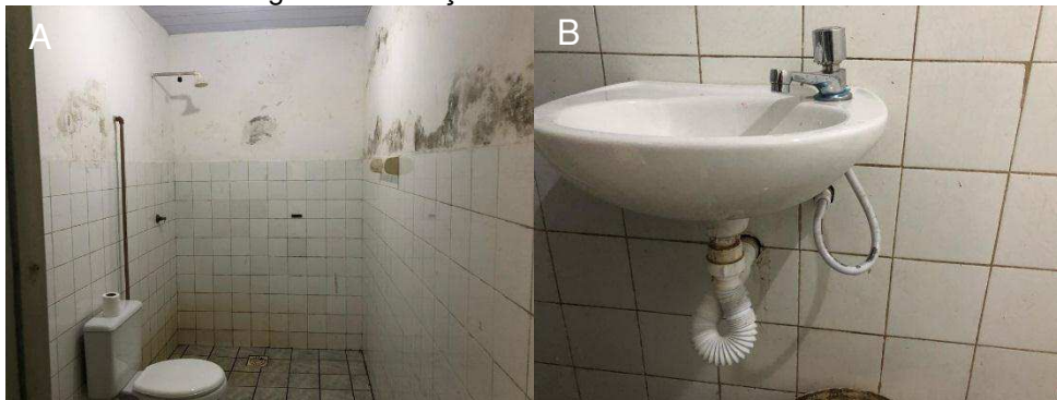
Figura 4 - Situações encontradas nas UBE's.
