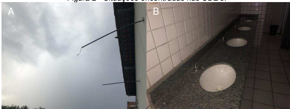
Figura 2 - Situações encontradas nas UBE's.
