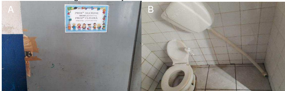
Figura 4 - Situações encontradas nas UBE's.
