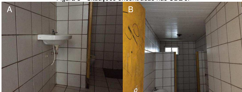
Figura 3 - Situações encontradas nas UBE's.
