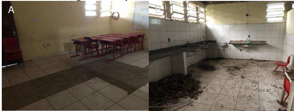
Figura 3 - Situações encontradas nas UBE's.
