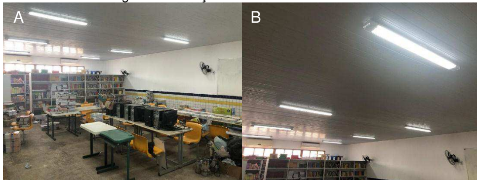
Figura 1 - Situações encontradas nas UBE's.
