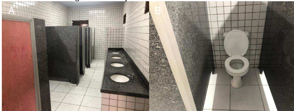
Figura 2 - Situações encontradas nas UBE's.
