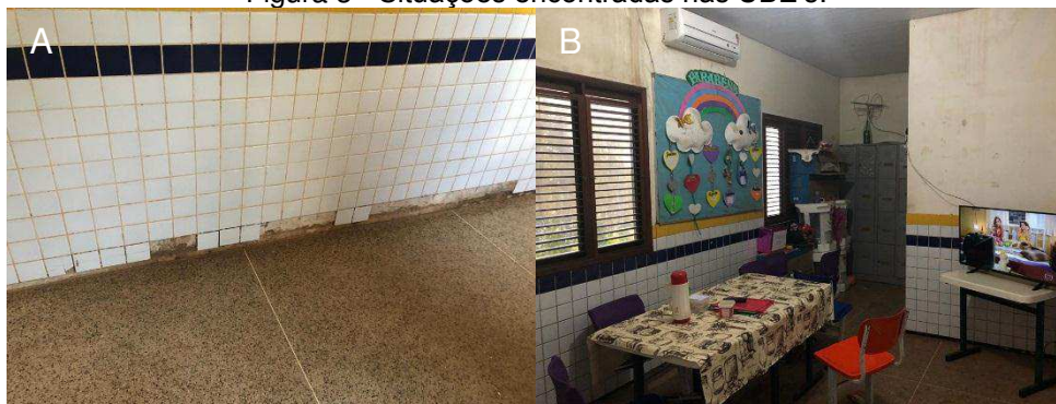
Figura 3 - Situações encontradas nas UBE's.
