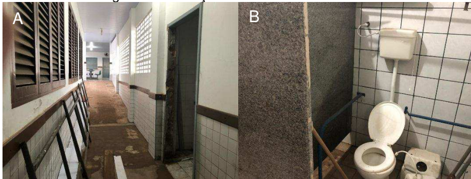
Figura 10 - Situações encontradas nas UBE's.
