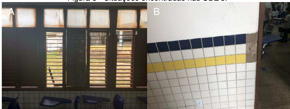
Figura 3 - Situações encontradas nas UBE's.
