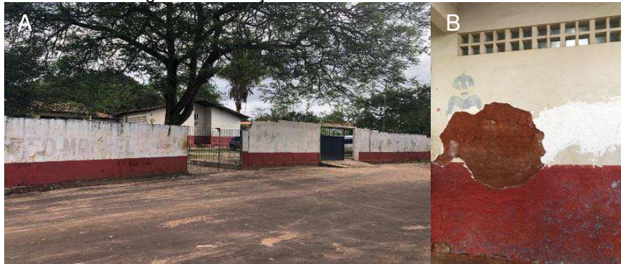
Figura 1 - Situações encontradas nas UBE's.
