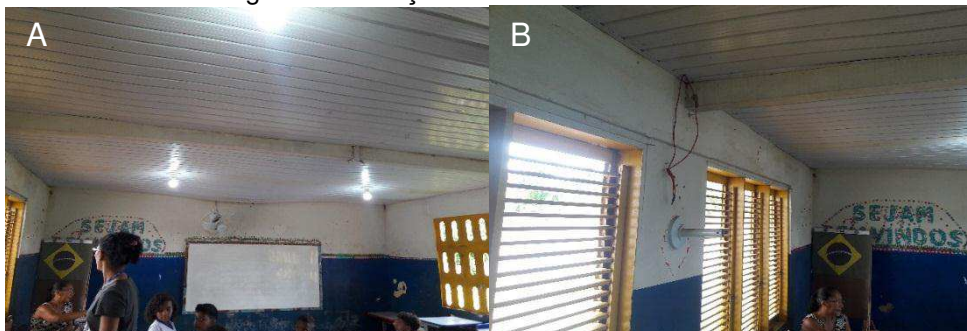
Figura 2 - Situações encontradas nas UBE's.
