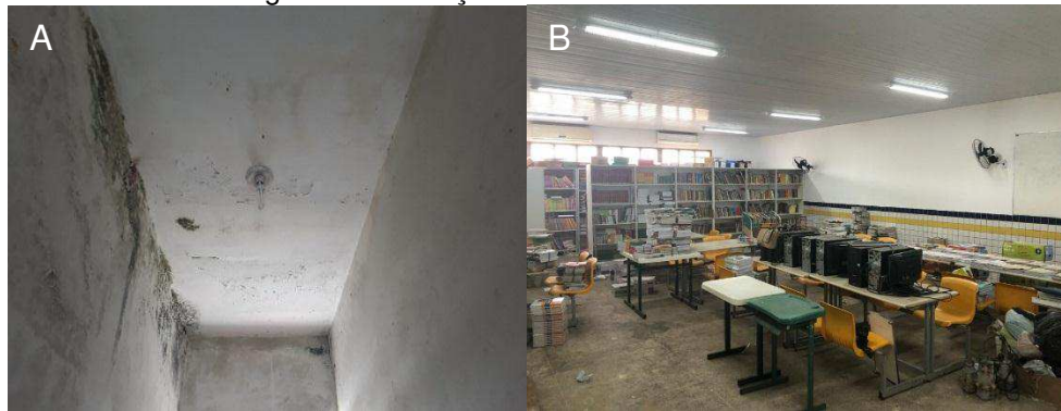
Figura 11 - Situações encontradas nas UBE's.
