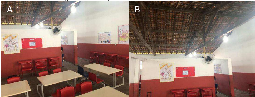
Figura 2 - Situações encontradas nas UBE's.
