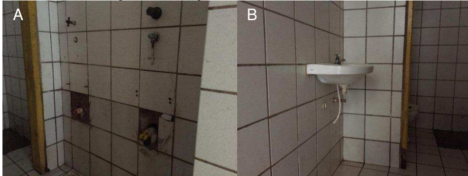
Figura 6 - Situações encontradas nas UBE's.
