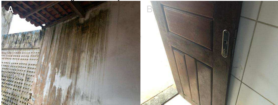
Figura 4 - Situações encontradas nas UBE's.
