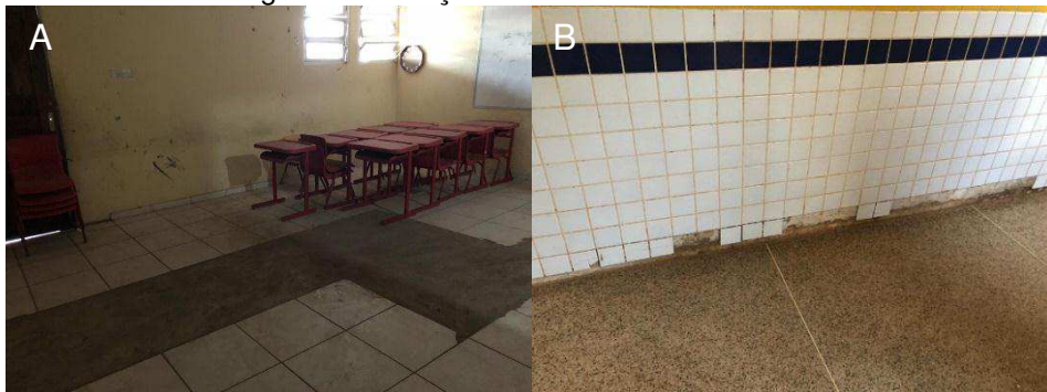
Figura 3 - Situações encontradas nas UBE's.
