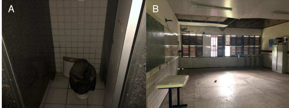
Figura 3 - Situações encontradas nas UBE's.
