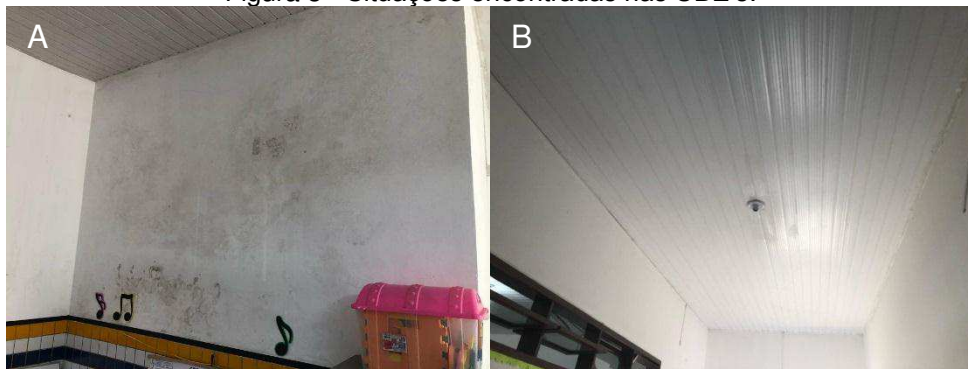
Figura 3 - Situações encontradas nas UBE's.
