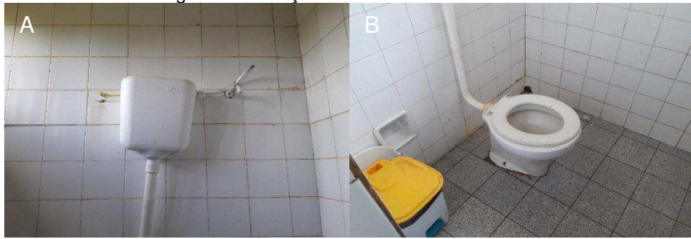
Figura 4 - Situações encontradas nas UBE's.
