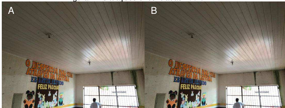
Figura 4 - Situações encontradas nas UBE's.
