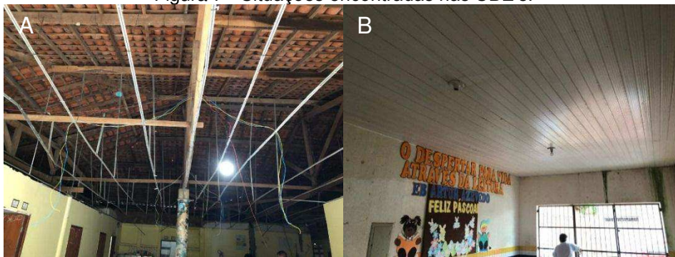
Figura 7 - Situações encontradas nas UBE's.
