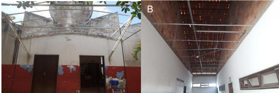
Figura 1 - Situações encontradas nas UBE's.
