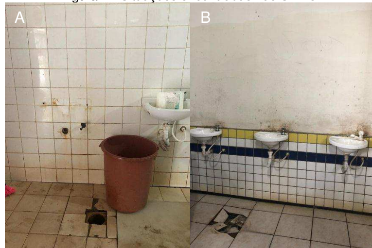
Figura 4 - Situações encontradas nas UBE's.
