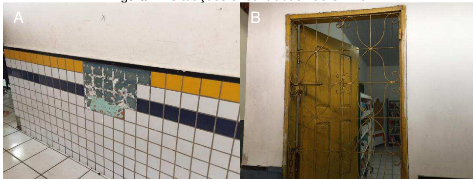
Figura 4 - Situações encontradas nas UBE's.
