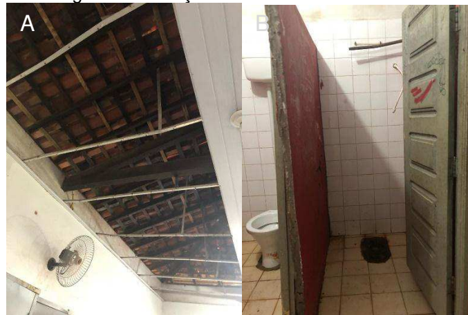
Figura 3 - Situações encontradas nas UBE's.
