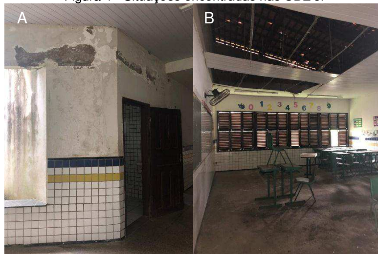
Figura 4 - Situações encontradas nas UBE's.
