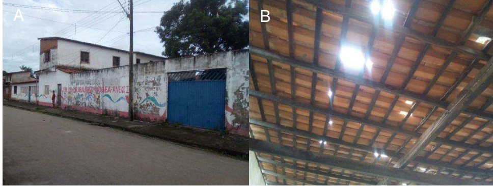
Figura 1 - Situações encontradas nas UBE's.
