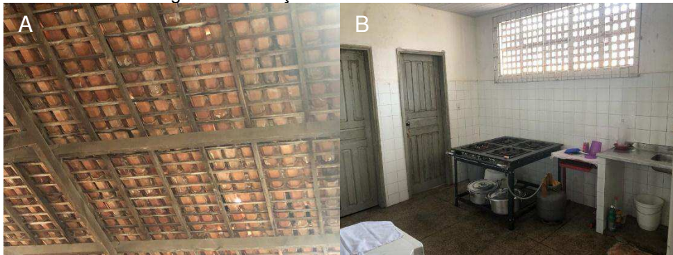
Figura 4 - Situações encontradas nas UBE's.
