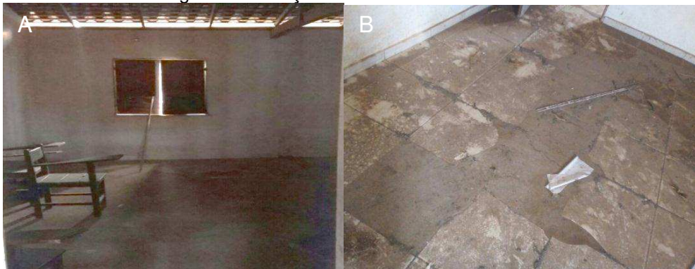
Figura 2 - Situações encontradas nas UBE's.
