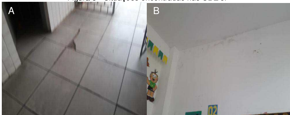
Figura 3 - Situações encontradas nas UBE's.
