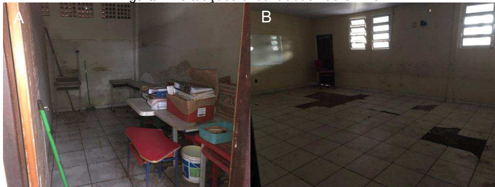
Figura 4 - Situações encontradas nas UBE's.
