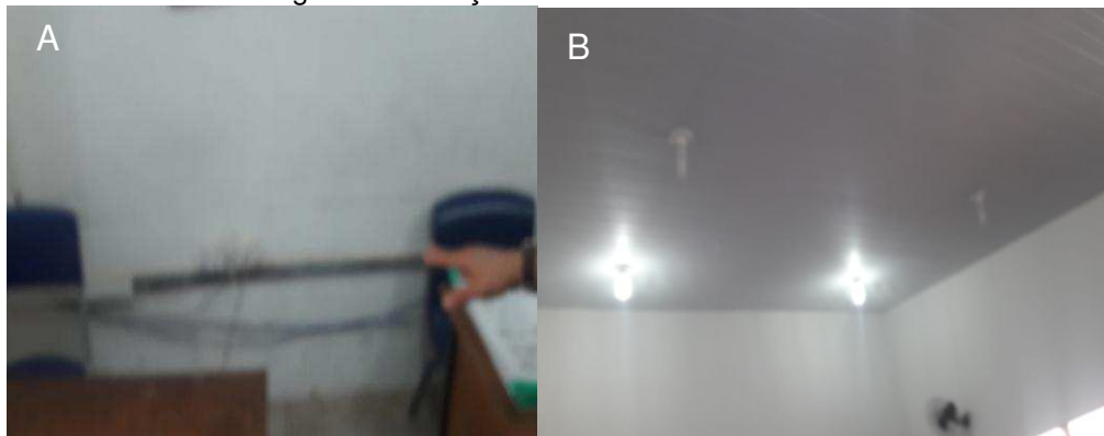
Figura 2 - Situações encontradas nas UBE's.
