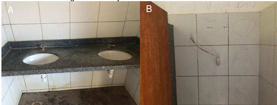
Figura 3 - Situações encontradas nas UBE's.
