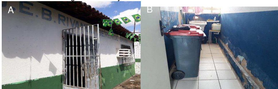
Figura 1 - Situações encontradas nas UBE's.
