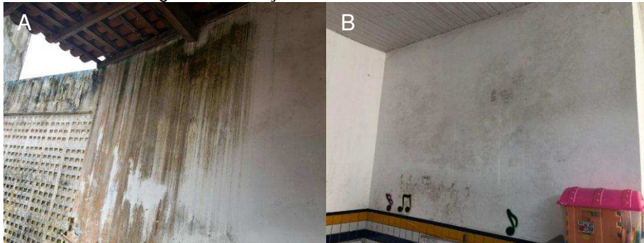
Figura 9 - Situações encontradas nas UBE's.
