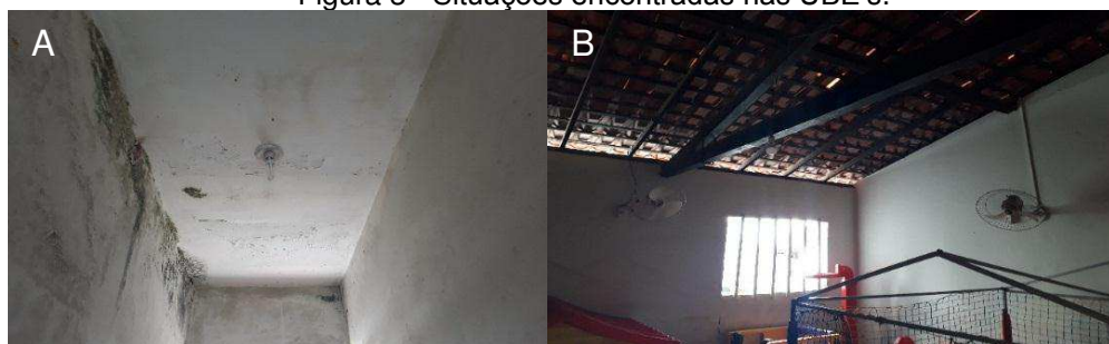
Figura 3 - Situações encontradas nas UBE's.
