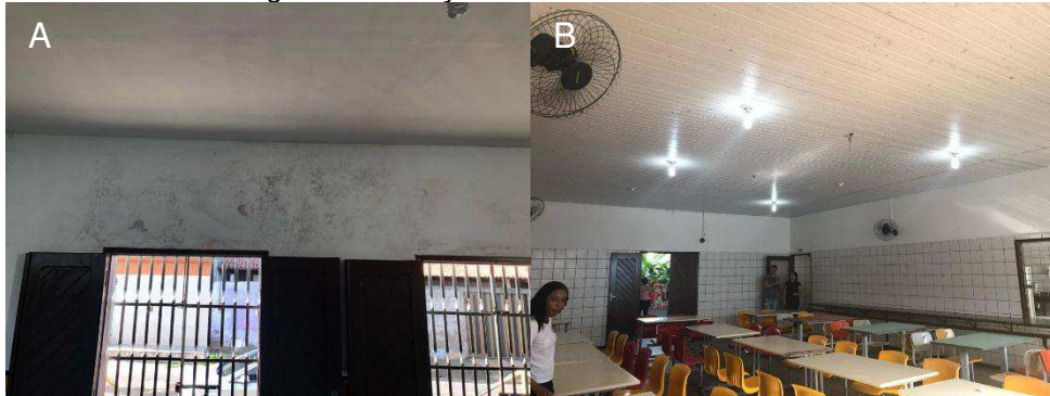
Figura 2 - Situações encontradas nas UBE's.
