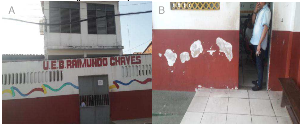
Figura 1 - Situações encontradas nas UBE's.
