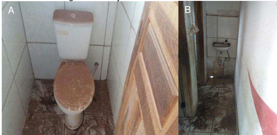
Figura 4 - Situações encontradas nas UBE's.
