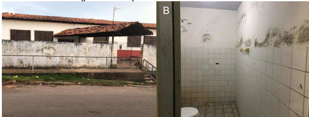
Figura 1 - Situações encontradas nas UBE's.
