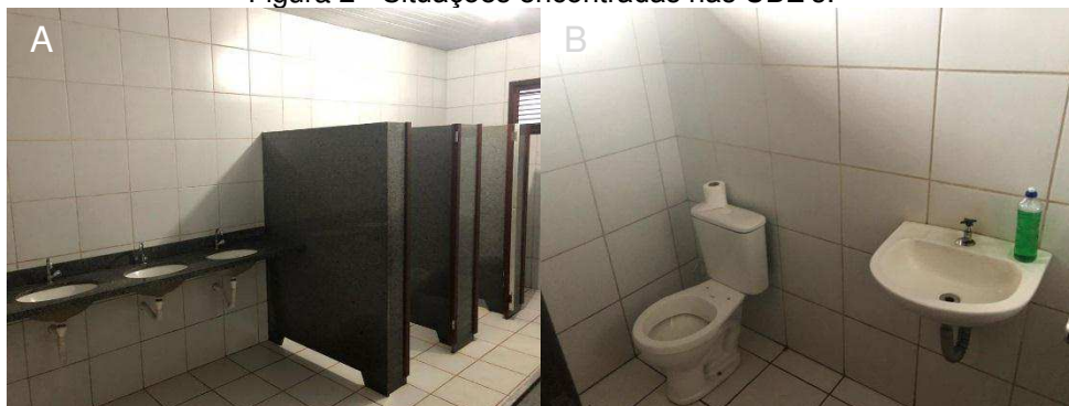
Figura 2 - Situações encontradas nas UBE's.
