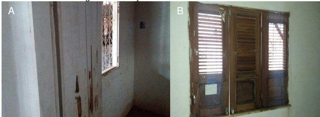
Figura 3 - Situações encontradas nas UBE's.
