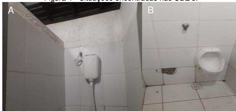
Figura 4 - Situações encontradas nas UBE's.
