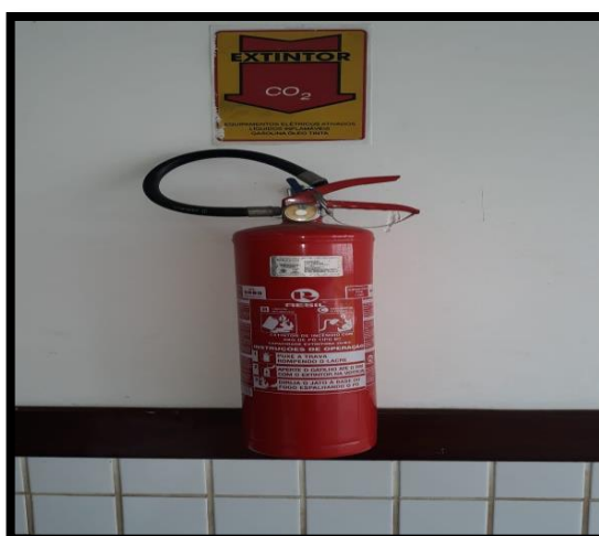
Figura 16 - Extintor com sinalização incorreta
