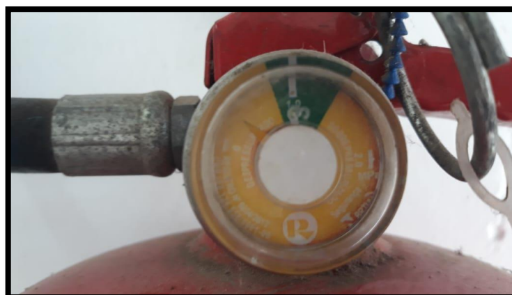
Figura 18 - Manômetro do extintor
