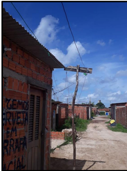
Figura 4 - Instalação elétrica improvisada no bairro Coroadinho, São Luís -MA
