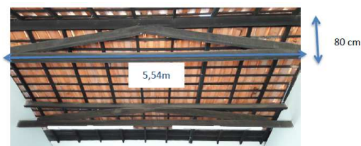
Figura 29 – Tesoura do telhado.
