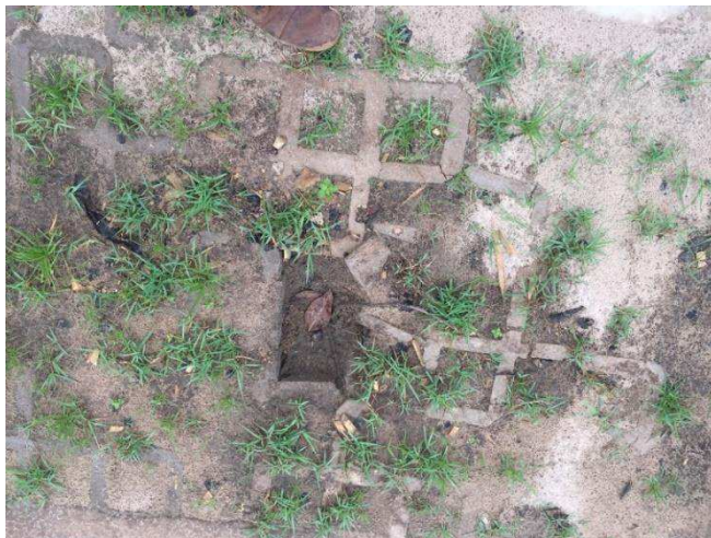
Figura 25 - Desprendimento de pisograma
