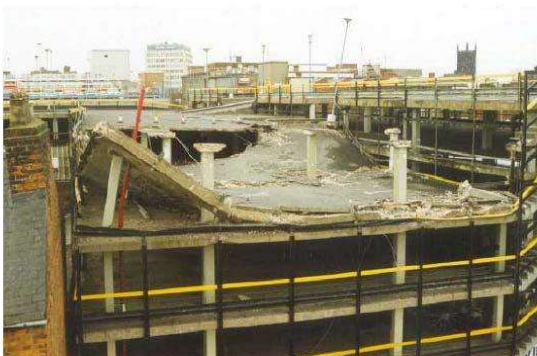
Figura 12 – Colapso parcial da laje em Wolverhampton, Inglaterra
