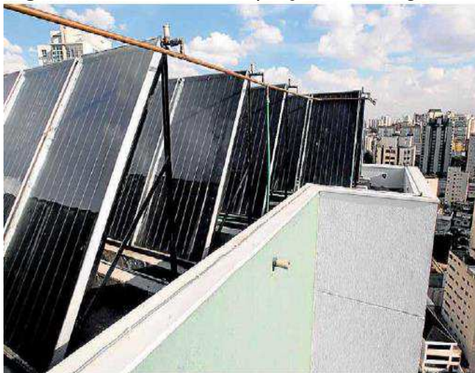
Figura 15 – Placas de captação de energia no Edifício True Chácara Klabin
