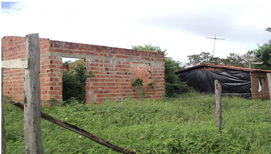
Figura 38 - Casa em construção pelo PMCMV e embargada. Ao lado, a casa em que residem. Fonte: Própria autora em coleta de campo realizada (maio, 2013).
