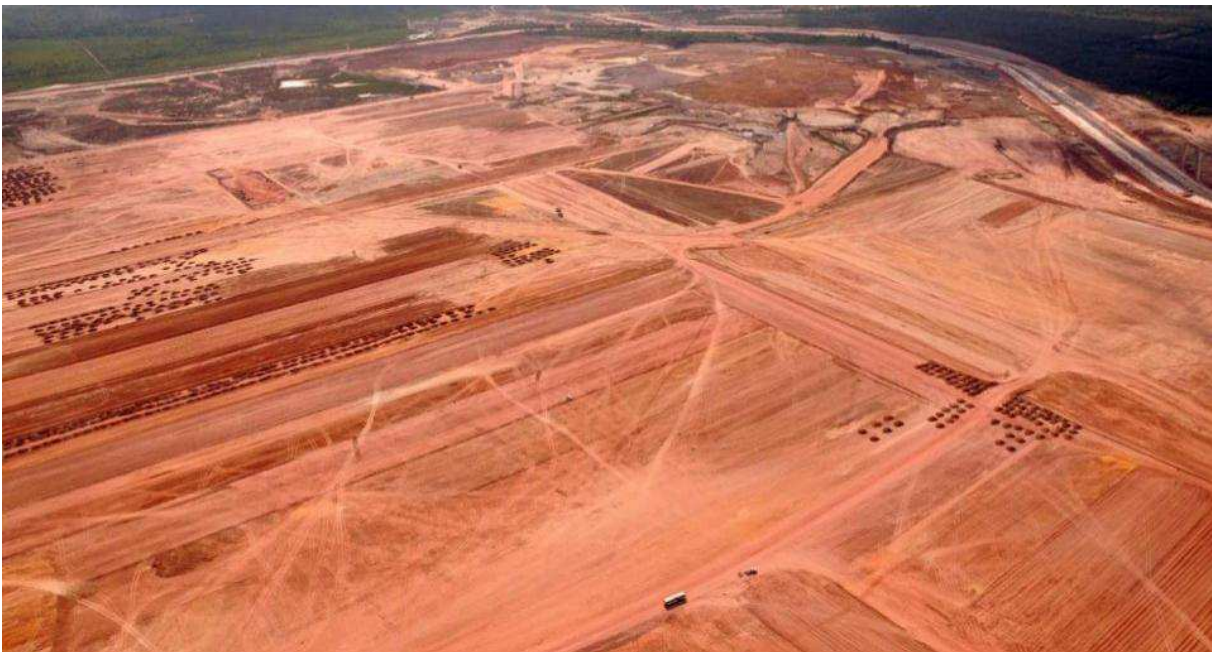
Figura 41 - Vista aérea do local onde será instalada a Refinaria Premium I, logo após a conclusão da fase de terraplenagem (Bacabeira-MA, 2013).
