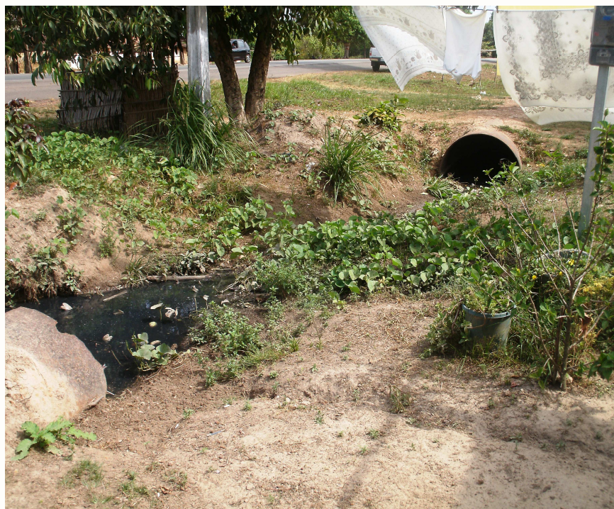
Figura 27 - Esgoto doméstico. Povoado Vila Cearense – Km-56, Bacabeira - MA 25
