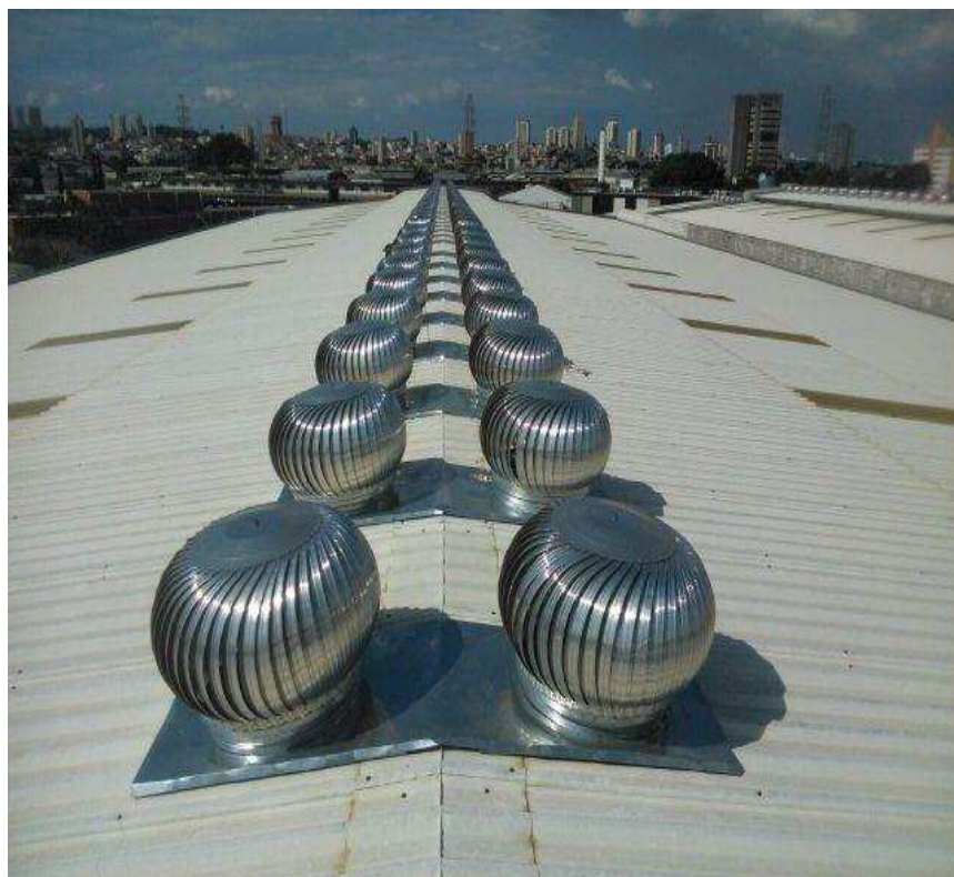
Figura 4.28: Exaustores eólicos instalados (adaptado do site disponível em: < http://www.ciadosexhaustores.com.br/informacoes/exaustor-eolico-preco.php >. Acesso em: 05/05/2018).
