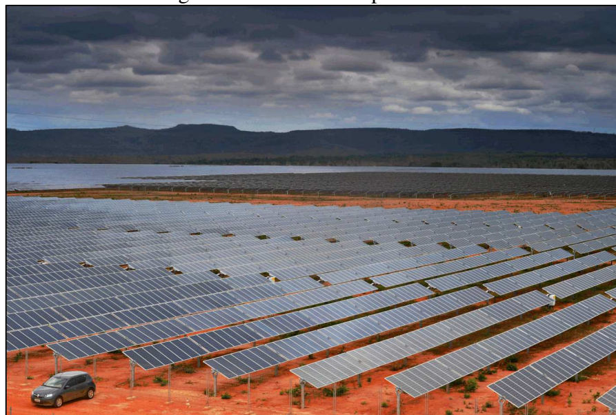
Figura 4 - Usina de Pirapora – MG
