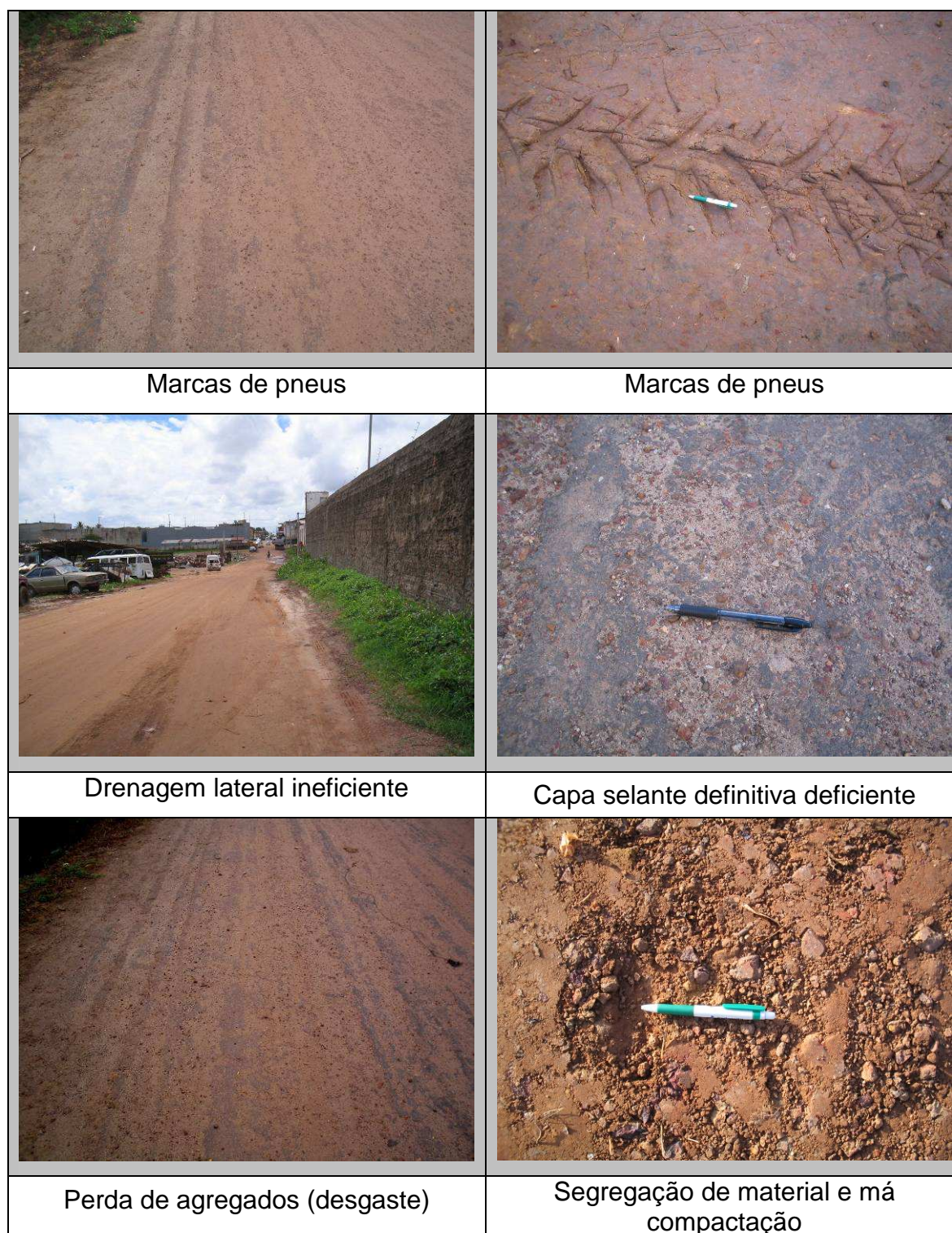
Figura 7.19 – Outros defeitos observados nos trechos experimentais 1 e 2.
