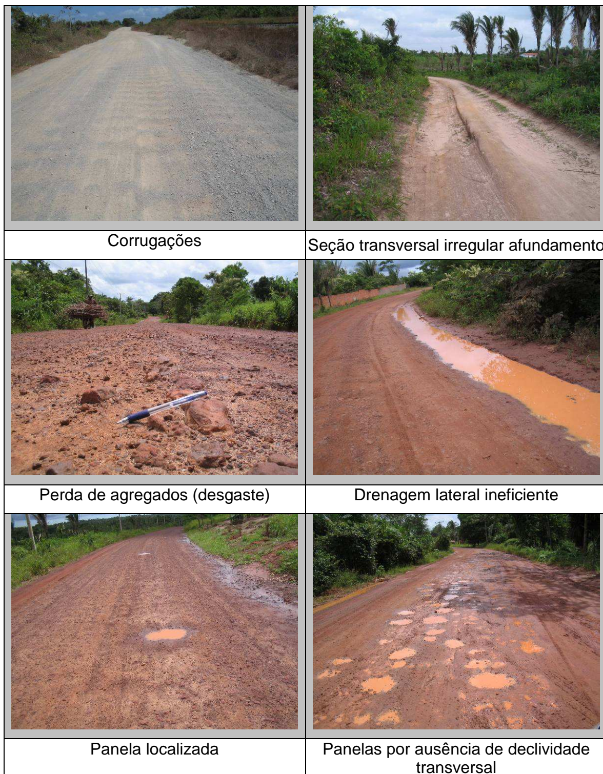
Figura 7.20 – Defeitos característicos de rodovias de BVT com revestimento primário de cascalho laterítico na ilha de São Luís.
