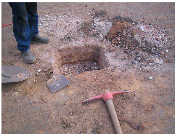
Figura 7.11 – Trincheira aberta para sondagem e coleta de material das camadas de pavimento
