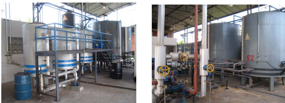
Figura 3.3 – Tanques de armazenamento de matérias-primas (esquerda) e das fases aquosas (direita) em fábrica de emulsões
