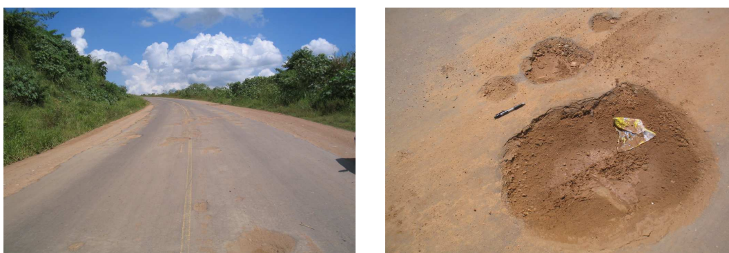
Figura 2.4 – Segmento com presença de defeitos. Detalhe de panela.
