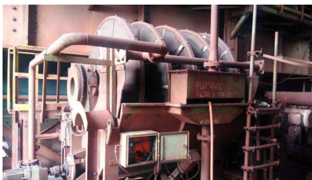
Figura 2.9 - Foto do Filtro a Disco da UPSL.
