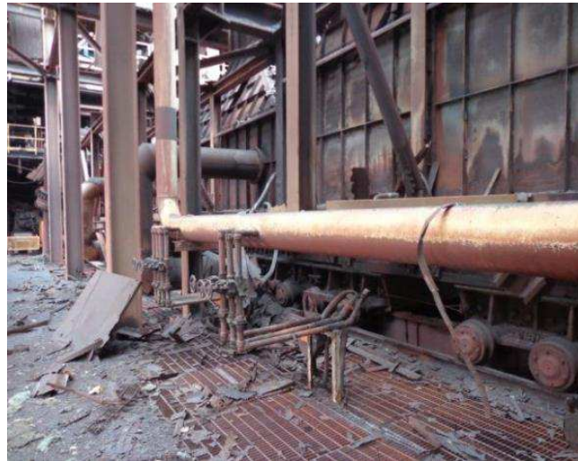
Figura 30 – Detalhe da situação das tubulações de água, mangotes e válvulas lado esquerdo.
