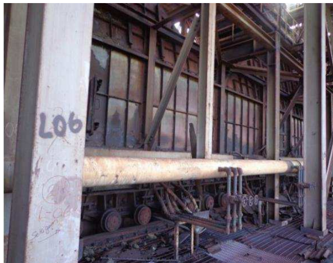
Figura 31 – Detalha da situação das tubulações de água, mangotes e válvulas lado direito
