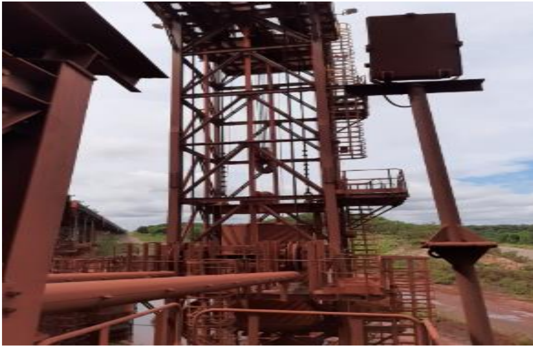
Figura 16: Contrapeso do sistema de esticamento (Autor, 2019)
