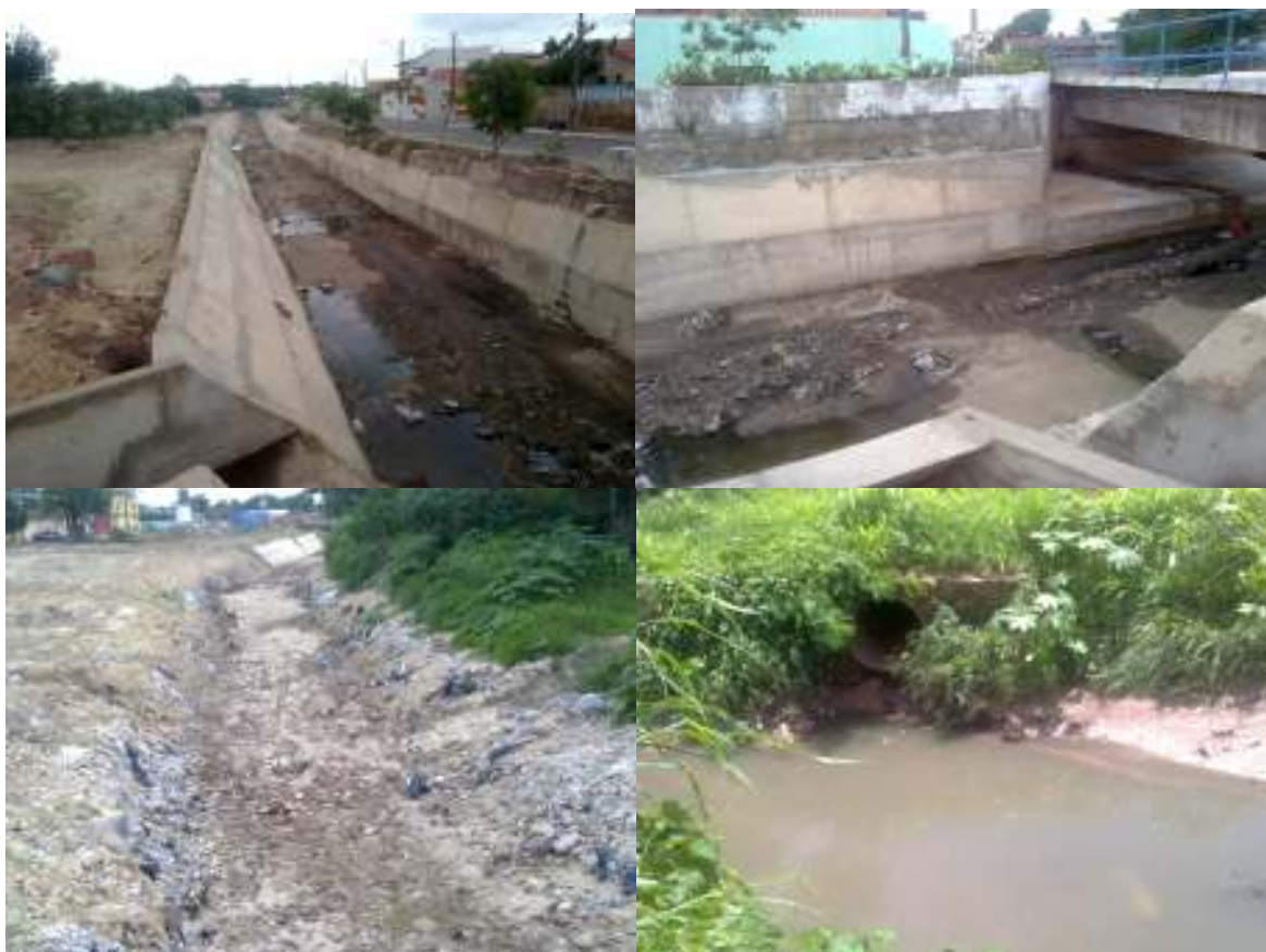
Figura 13: Obra antes e depois das chuvas acumula esgoto e resíduos próximo a residências no Planalto.
