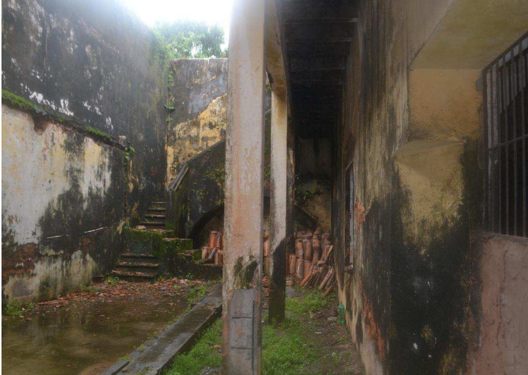
Fotografia 14 – Pilares e viga comprometidos pela carbonatação
