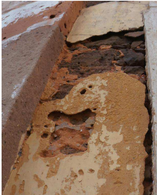
Fotografia 5 – Argamassa da fachada comprometida após ataque ácido
