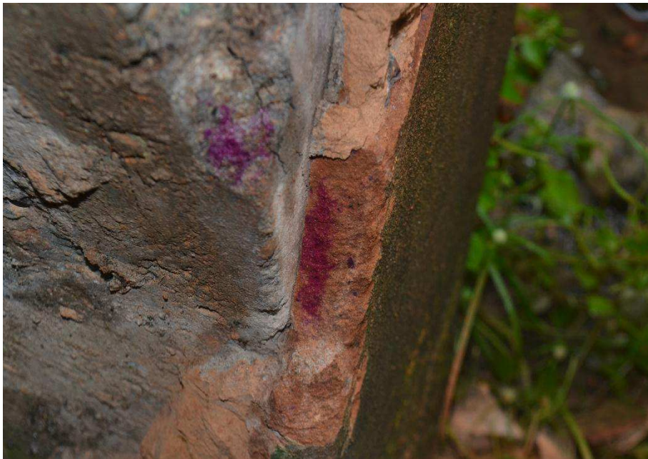
Fotografia 19 – Parte de concreto em bom estado (representado pela cor rosa)
