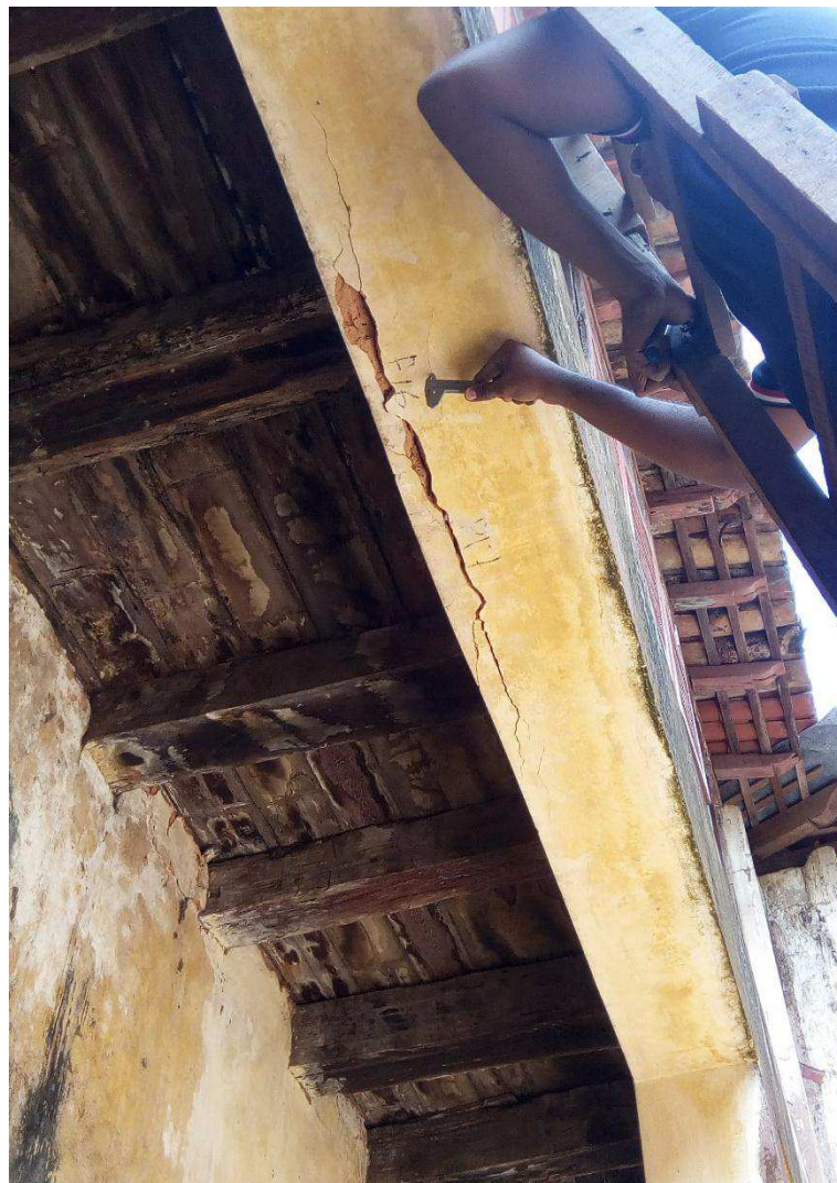
Fotografia 9 – Viga de concreto com danos estruturais
