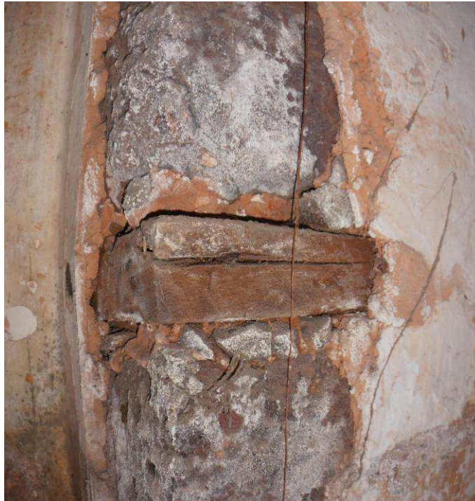
Fotografia 6 – Argamassa do interior do casarão comprometida após ataque ácido
