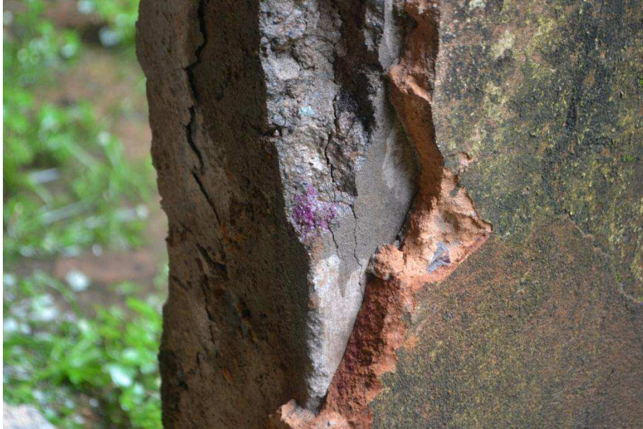
Fotografia 18 – Enfatização da carbonatação – toda parte cinza
