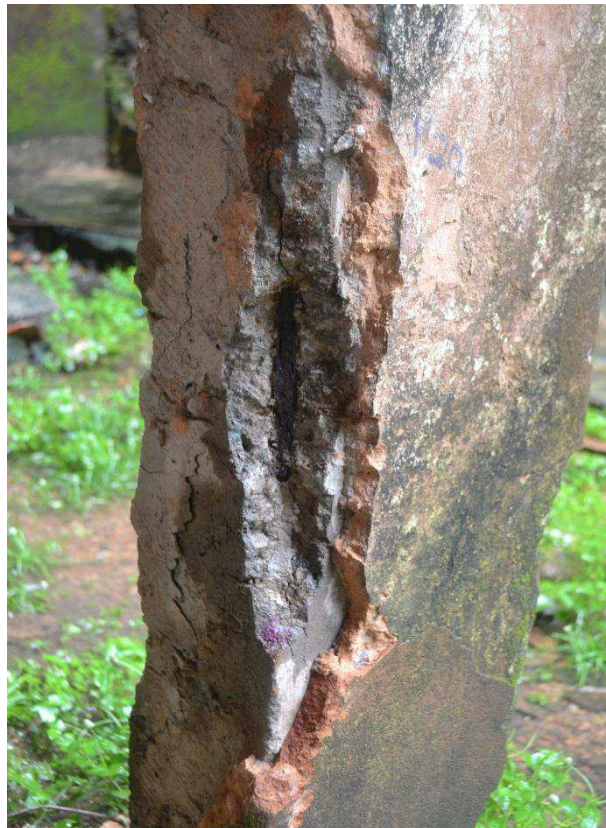
Fotografia 17 – Estrutura de concreto totalmente carbonatada
