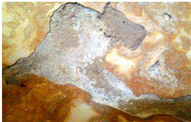
Fotografia 4 – Argamassa em estado de desagregação
