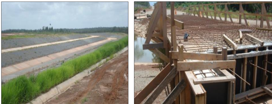
Figura 16- Canal de Drenagem, Proteção de Talude, Colchão Reno; Construção de Ponte, Obra paralisada.
