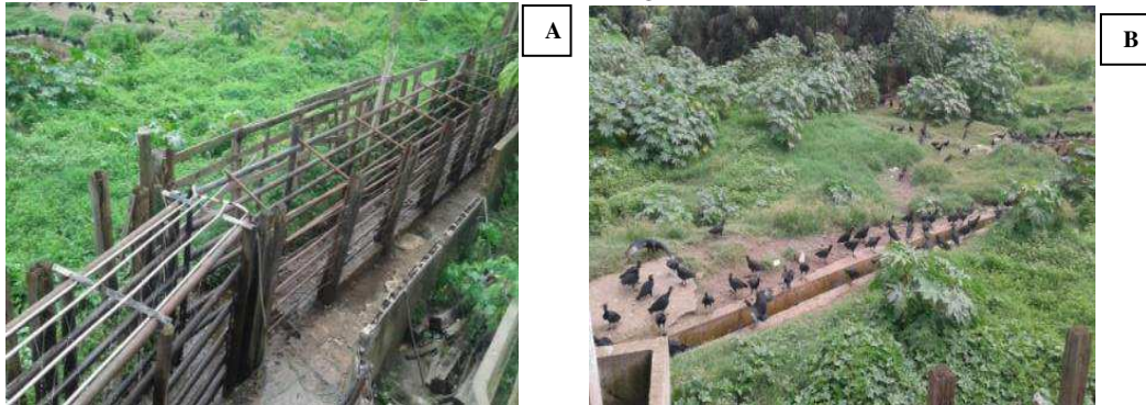
Figuras 7 - Área de banho de aspersão. (A, B) Esgoto e urubus na área do banho no matadouro B.
