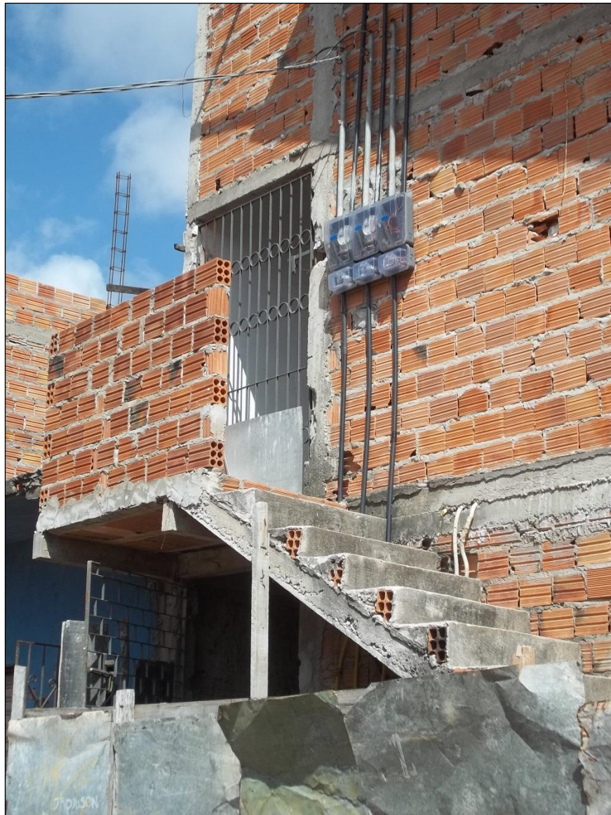
Figura 19 - Moradia da “Vila” Progresso com escada de acesso perigosa
