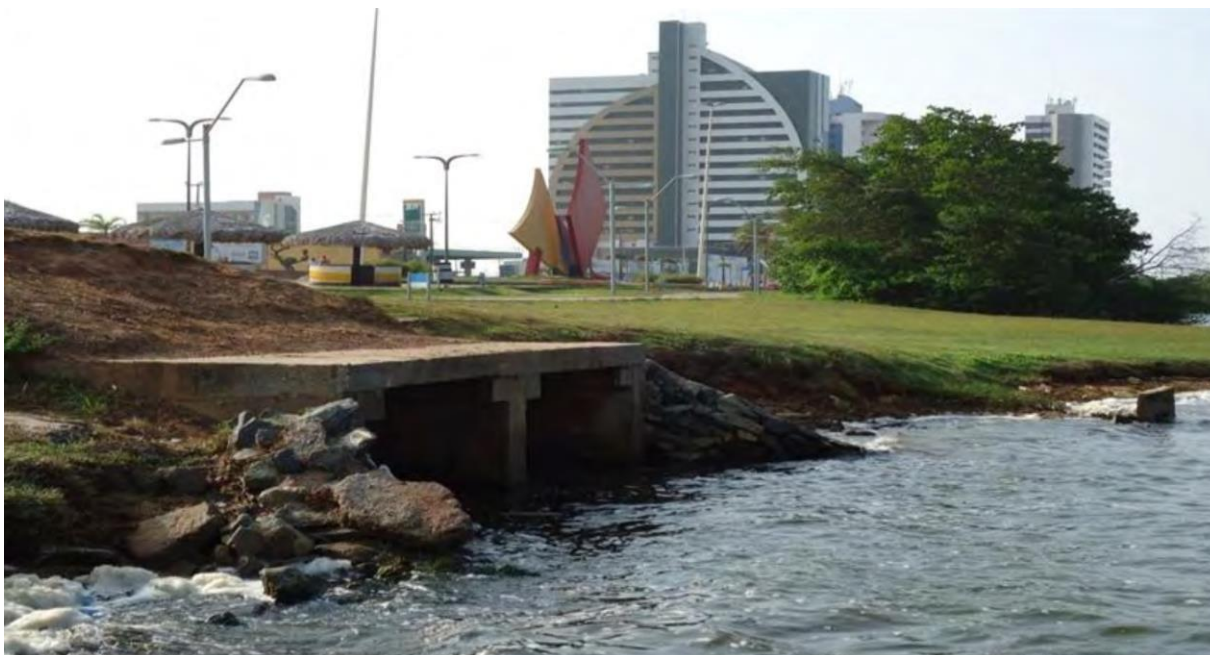
Figura 11– Bueiro duplo celular. Única ligação da lagoa da Jansen ao mar, não sendo suficiente (2011)
