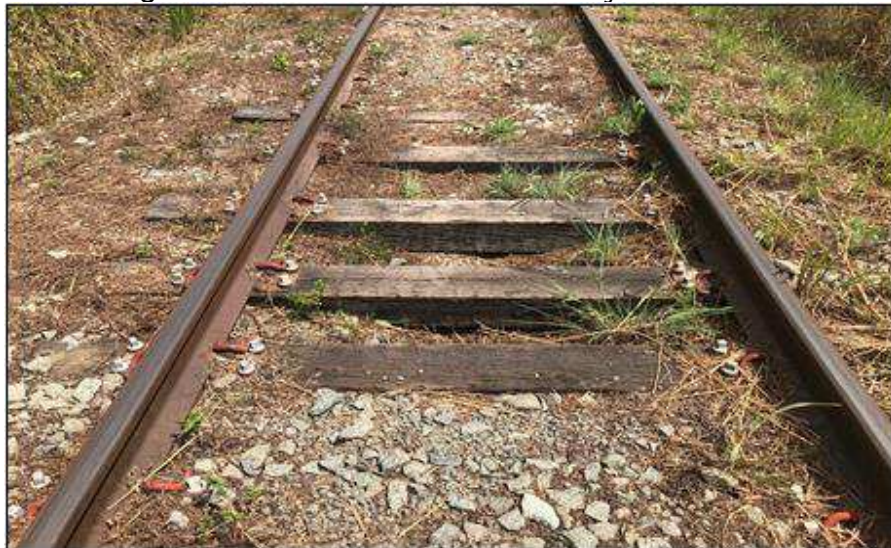
Figura 45 - Insuficiência e colmatação do lastro.
