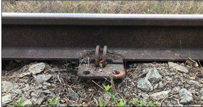
Figura 38 - Ausência de dormentes e tirefões na via.
