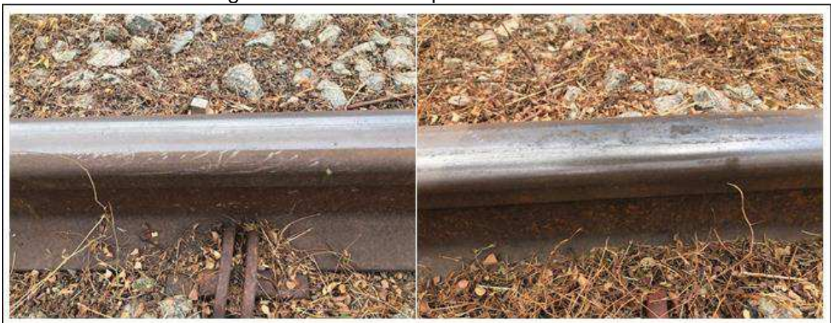
Figura 43 - Defeitos superficiais em trilhos.
