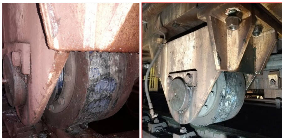
Figura 5.5: Detalhe da roda vertical avariada no local do evento (Alimentador de sapatas (Arquivo Técnico, 2019).
