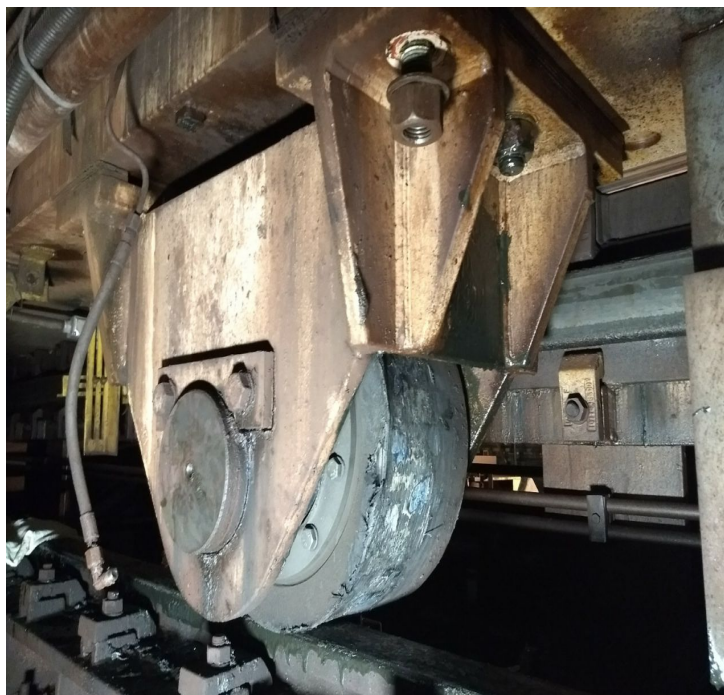
Figura 5.3: Roda vertical avariada do carro posicionador (Arquivo Técnico, 2019).
